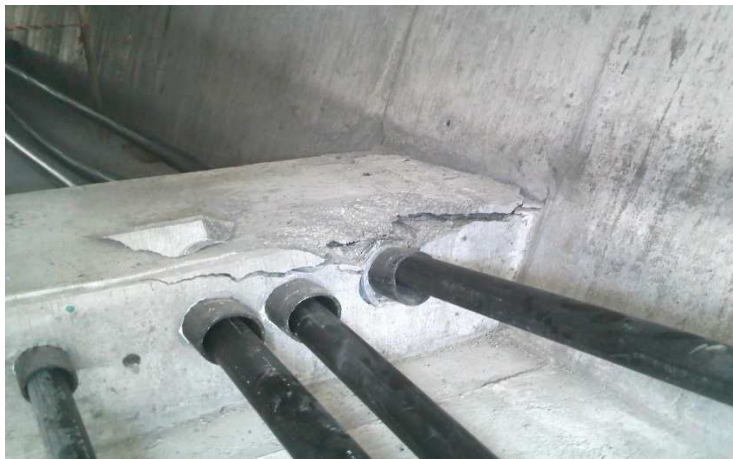
Rys. 7. Widok zniszczonego fragmentu dewiatora
