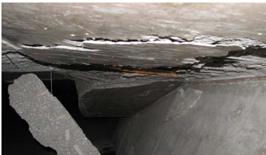
Rys. 3. Widok górnej płyty skrzynki bezpośrednio po awarii
