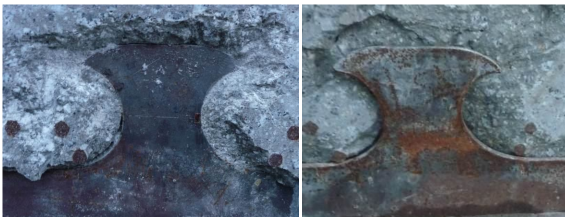
Rys. 3. Widoczne miejsca docisku betonu do stali (po lewej) oraz deformacja łącznika stalowego wskazująca na utwierdzenie jego górnej części w betonie
