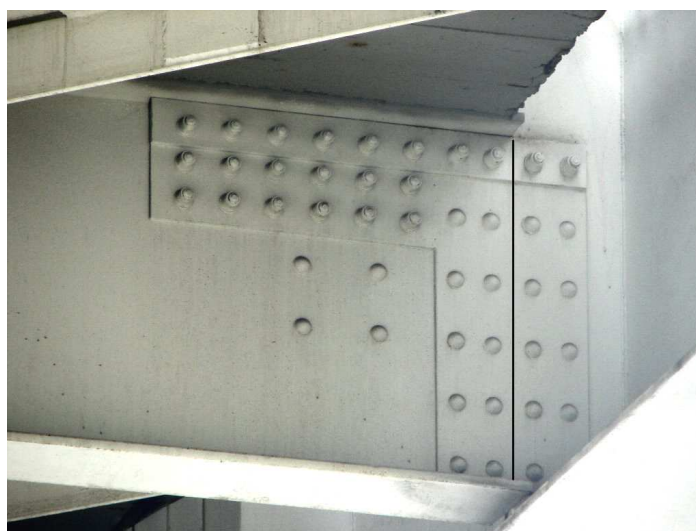
Rys.4. Połączenie poprzecznic zespolonej z żeberkiem przy środku pasa dolnego dźwigara kratowego (linią zaznaczono lokalizację styku belki poprzecznej i żeberka przy środku pasa dolnego kraty); widoczna krawędź płyty pomostu
