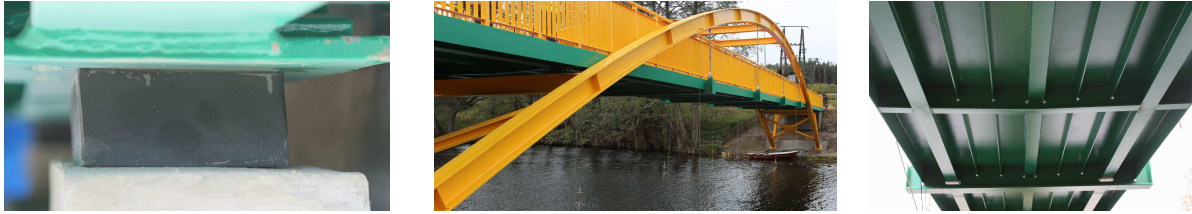
Rys. 9. Zarejestrowana podczas badań deformacja łożyska, widok konstrukcji od strony podpory, pomost
