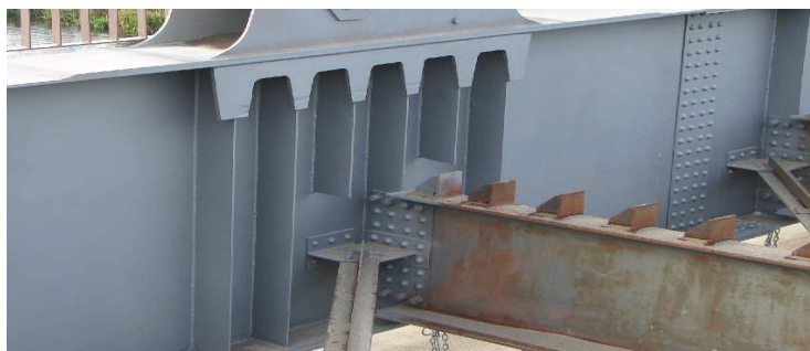
Rys.3. Przykład połączenia pasa dolnego dźwigara kratowego, poprzecznic i stężenia wiatrowego (widok przed wykonaniem płyty); widoczne opórki z kątowników; blacha węzłowa wiatrownic usztywnia połączenia poprzecznic z pasem dźwigara kratowego w płaszczyźnie poziomej
