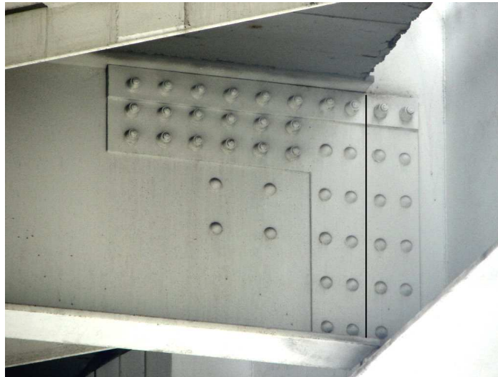
Rys.4. Połączenie poprzecznic zespolonej z żeberkiem przy środku pasa dolnego dźwigara kratowego (linią zaznaczono lokalizację styku belki poprzecznej i żeberka przy środku pasa dolnego kraty); widoczna krawędź płyty pomostu
