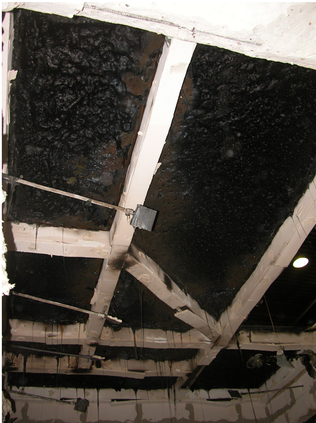
Rys. 4. Widok dachu przeszklonego od strony nagrzewanej po badaniu
