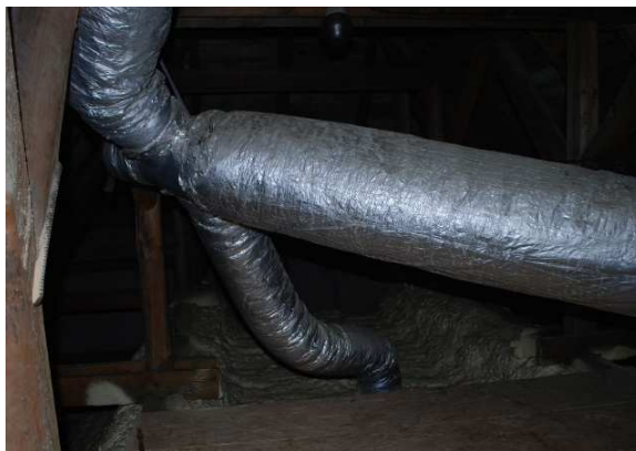
Rysunek 7. Przewody wentylacji wywiewnej Źródło: opracowanie własne.
