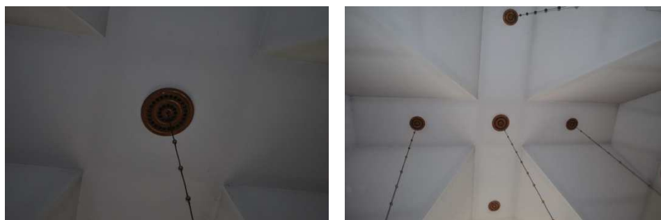
Rysunek 2,3. Otwory wentylacji naturalnej w najwyższej części stropu Źródło: opracowanie własne.
