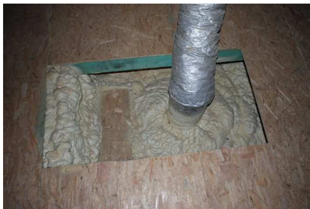
Rysunek 8. Podłączenie przewodów wentylacji mechanicznej w otworach w najwyższej części stropu Źródło: opracowanie własne.
