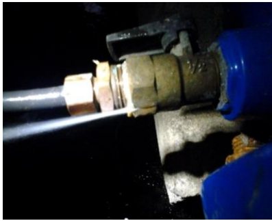
Rys. 22. Pęknięty zawór instalacji sterującej
